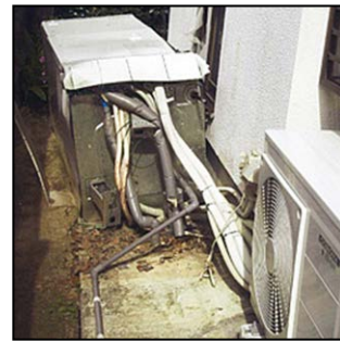
(b) 熊本地震での様子(転倒した給湯器の一例)
